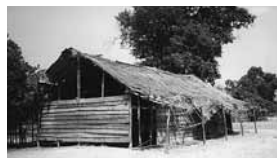
現在使われている校舎。屋根が落ちかけています。
